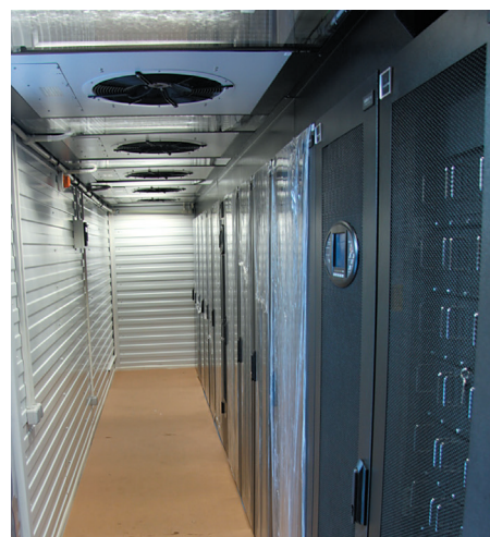
Рис. 3. Изоляция холодного коридора с кондиционерами Liebert HPS в первом в Украине МЦОД
