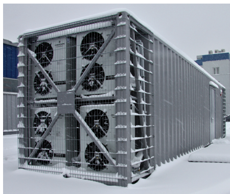
Рис. 1. Внешние блоки МЦОД утоплены в корпус основного контейнера и защищены решеткой
