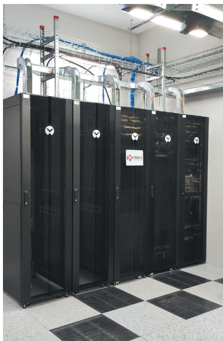
Рис. 1. Первая партия шкафов Vertiv, установленных в новом дата-центре DTEL-IX
