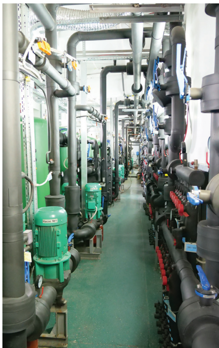
Гидромодуль дата-центра VeMobile
