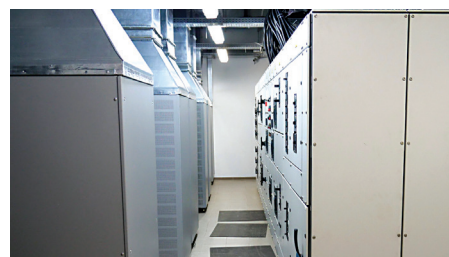
Силовой модуль дата-центра VeMobile
